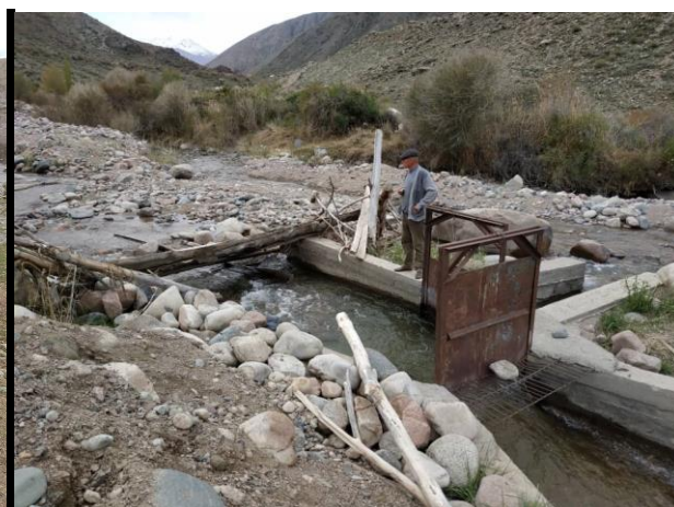
Фото №2.ГВС на канале «Тосорский», сентябрь 2019
